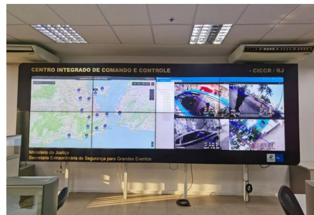
CICC centro de comando
